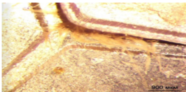
Рис. 2. Повреждения на образце № 2: в верхней части цилиндрического корпуса конденсатора наблюдается вздутие и разрыв насечки
